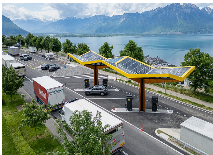
Mehr als 40 Rastplätze sind mit Schnellladestationen ausgerüstet.
